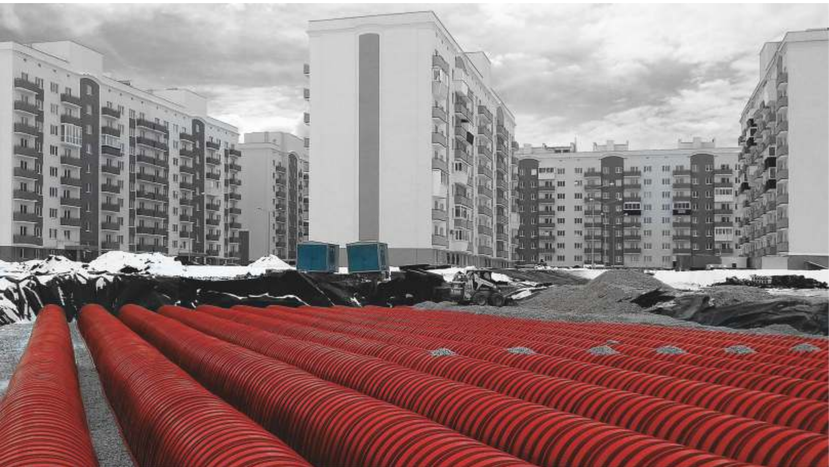
Система аккумулирования и регулирования сточных вод объемом 2 000 м 3 и производительностью 100 л/с. Самарская область, г. Самара, мкр. Южный Город
